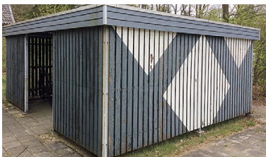
Vervuild/ aangetast hout
