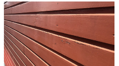
Zichtbare gebreken schilderwerk
